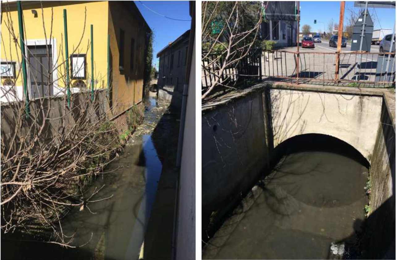
Figura 6 - Tratto parzialmente tombato del Torrente Guisa, soggetto a parziali ostruzioni da vegetazione.
